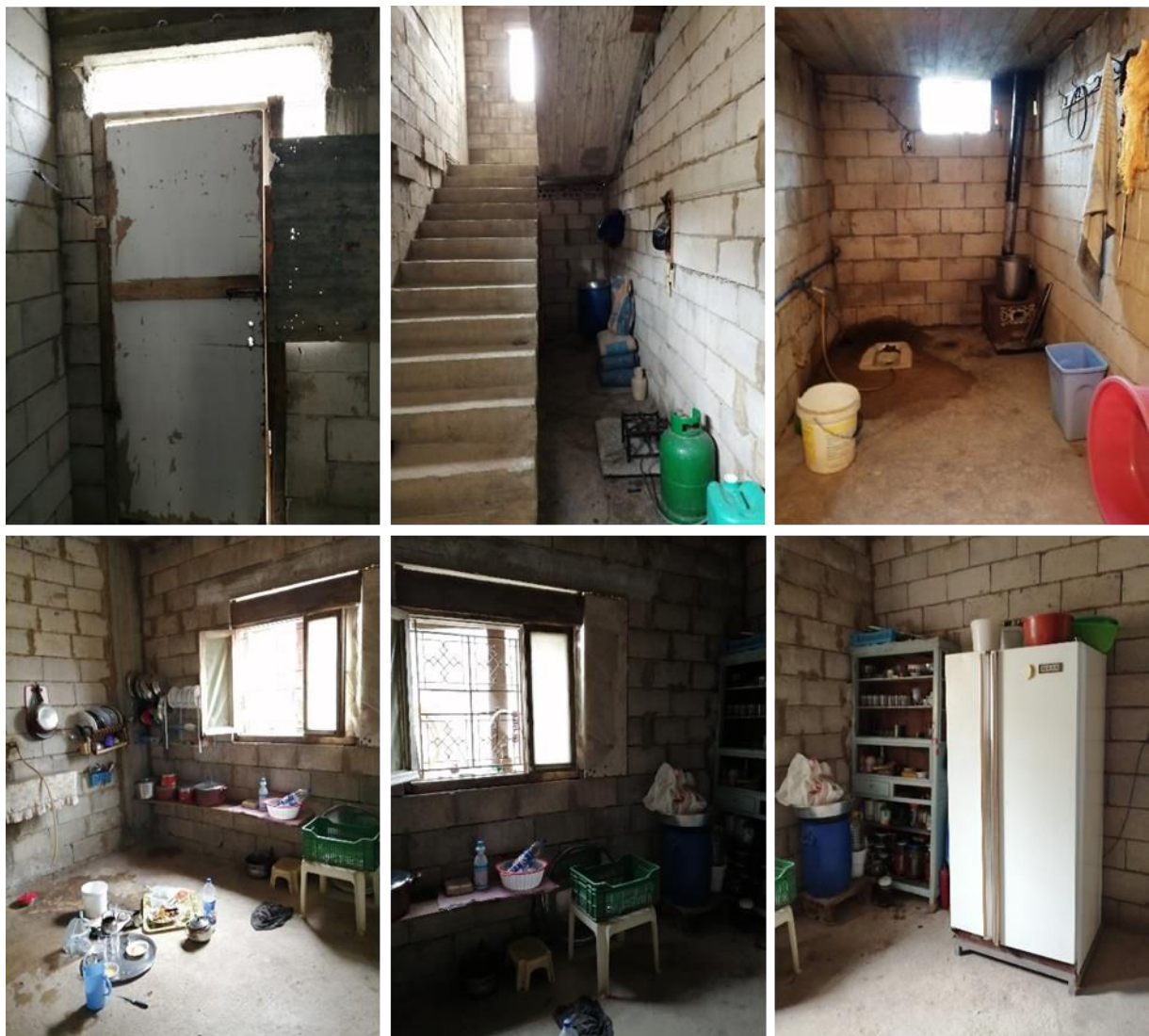
Figure 1. L'état d'un appartement avant le début de sa réhabilitation
